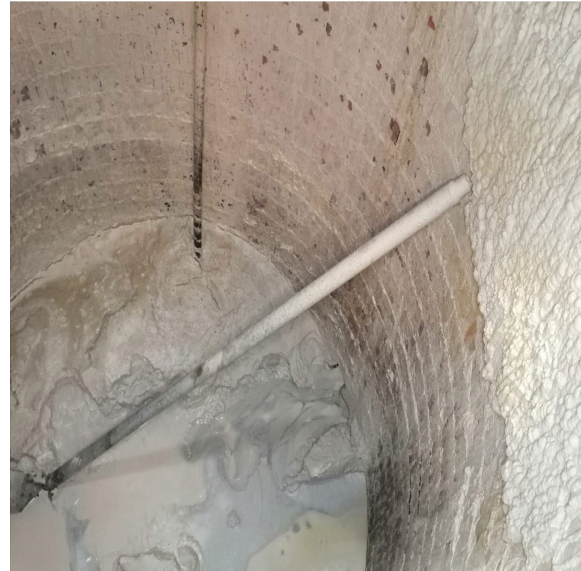
Рис.6. увеличившиеся в объеме залежи реагента привели к поломке вала перемешивающего устройства
